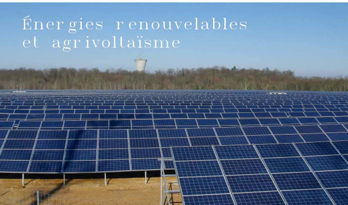
▲ Centrale photovoltaïque à Saint Léger, TSK, fabricant de la centrale
