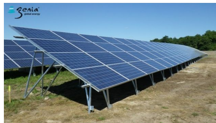
Centrale photovoltaïque au sol à Saint-Léger (Mairie de Saint-Léger)
