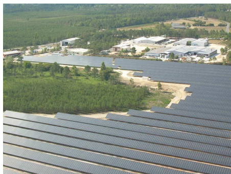
Centrale photovoltaïque au sol à Montendre (Ville de Montendre)
