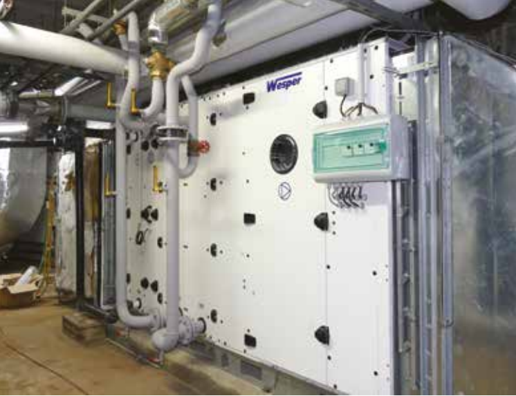
Chaufferie Les Antilles, Jonzac. Photo : © CDCHS / V. Sabadel
